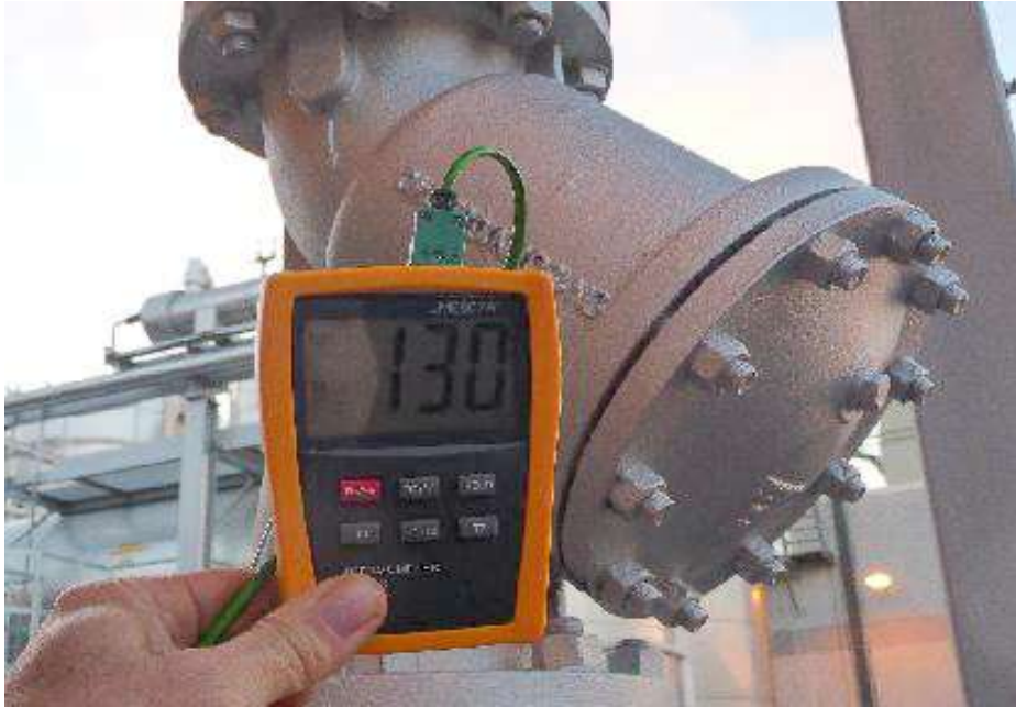
Sin aislar - Tubería cebada 130°C
